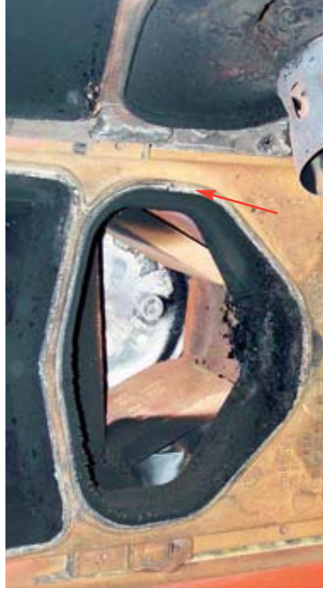
Cordone di amianto
