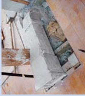
Canale di ventilazione in fibrocemento
