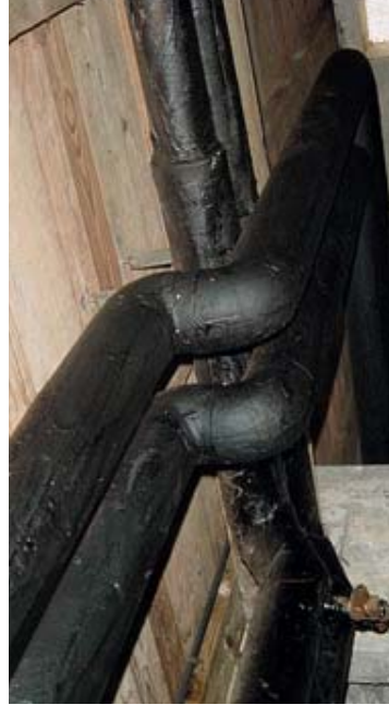
Guaina bituminosa contenente amianto
