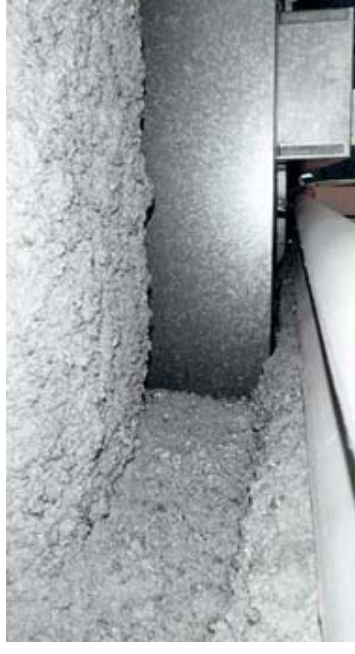
Amianto spruzzato come rivestimento antincendio su travi di acciaio
