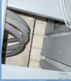
Barriera antifiama con cuscini di amianto
