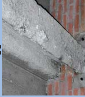
Isolamento in amianto spruzzato
