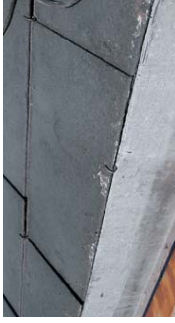
Pannelli di ardesia contenenti amianto
