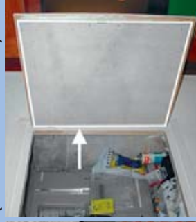
Pannello antincendio contenente amianto
