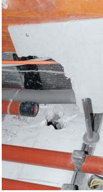
Pannello antincendio in colonna montante
