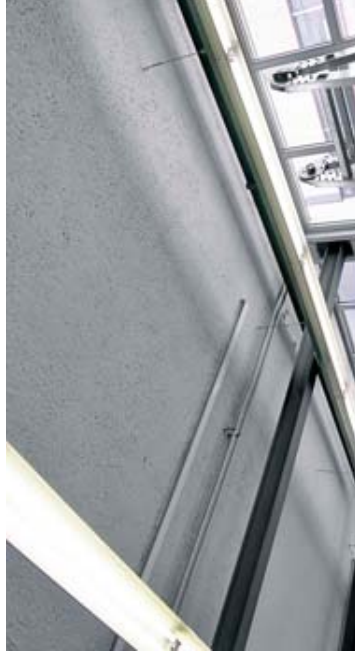
Rivestimento del soffitto in amianto spruzzato
