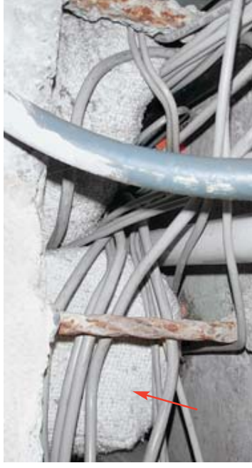
Barriere antifiamma contenenti amianto
