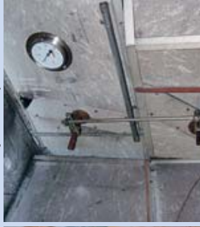
Impianto di ventilazione in fibrocemento
