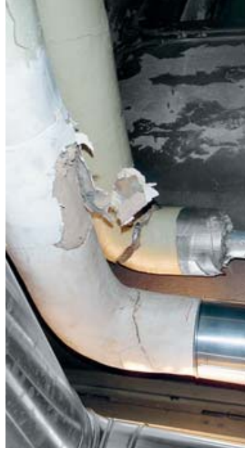
Tubo con malta contenente amianto
